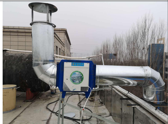
油烟净化装置排气筒
