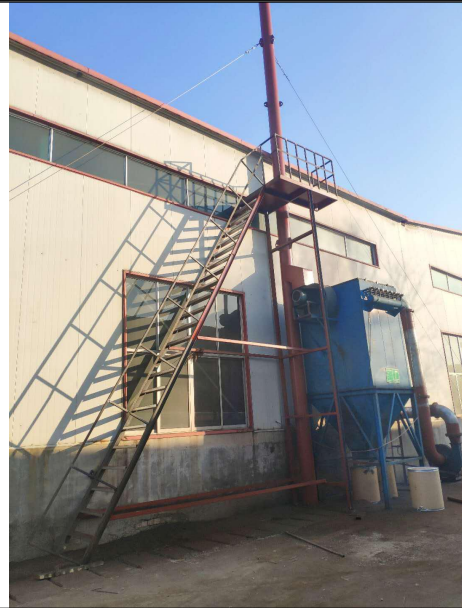
布袋除尘器采样平台+排气筒
