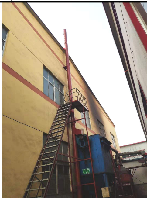
布袋除尘器+采样平台+排气筒
