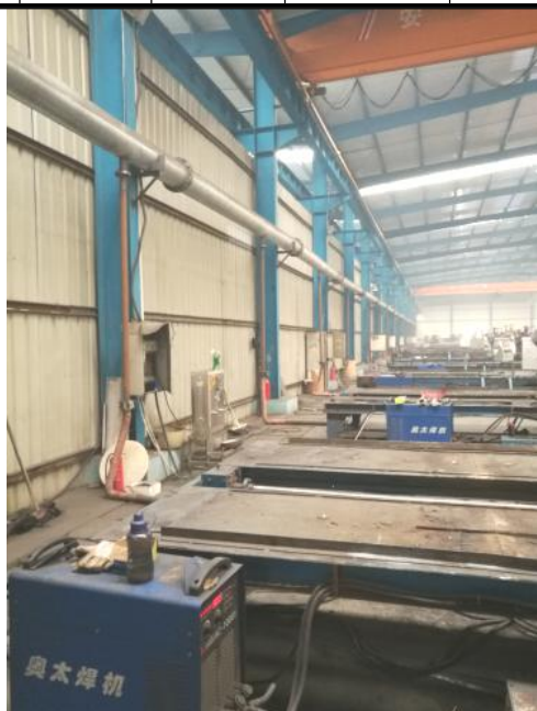
焊接烟尘集气管
