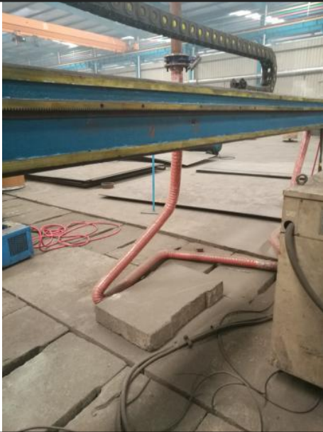
焊接烟尘集气管
